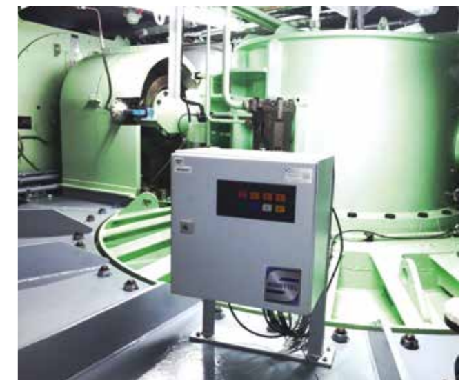
Im Maschinenraum werden die Daten mit Sensoren erhoben und ermöglichen eine Fernwartung.
